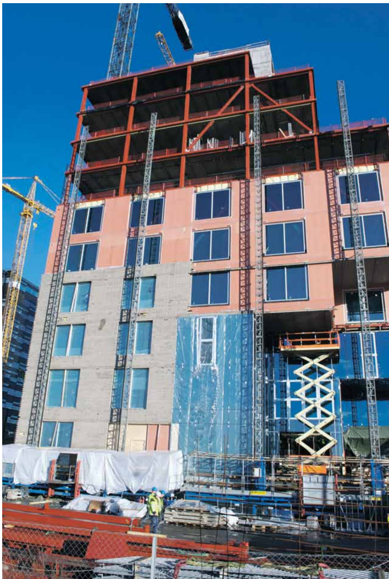
En ny bydel reiser seg i Bjørvika. På DnB Nor-bygget er det Rolf Holm som har murerjobben.
